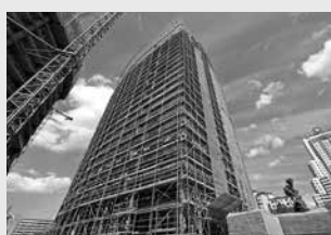
Pracovné lešenie fasádne
