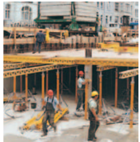
Stavba podzemnej garáže so zdvojenými nosníkmi GT 24. Stojky MULTIPROP s vysokou únosnosťou. Výhodou je menší počet stojok a rýchlosť.
