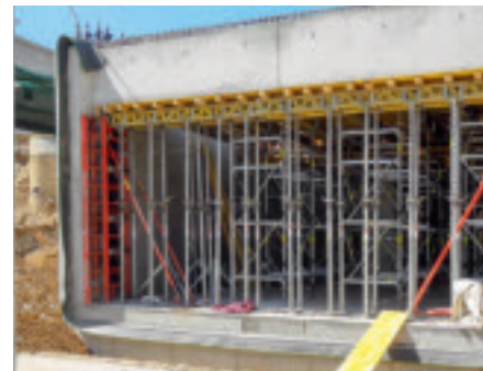
Stropné debnenie MULTIFLEX bolo kombinované s lešením PERI UP Rosett pre podopretie hrubých stropov.
