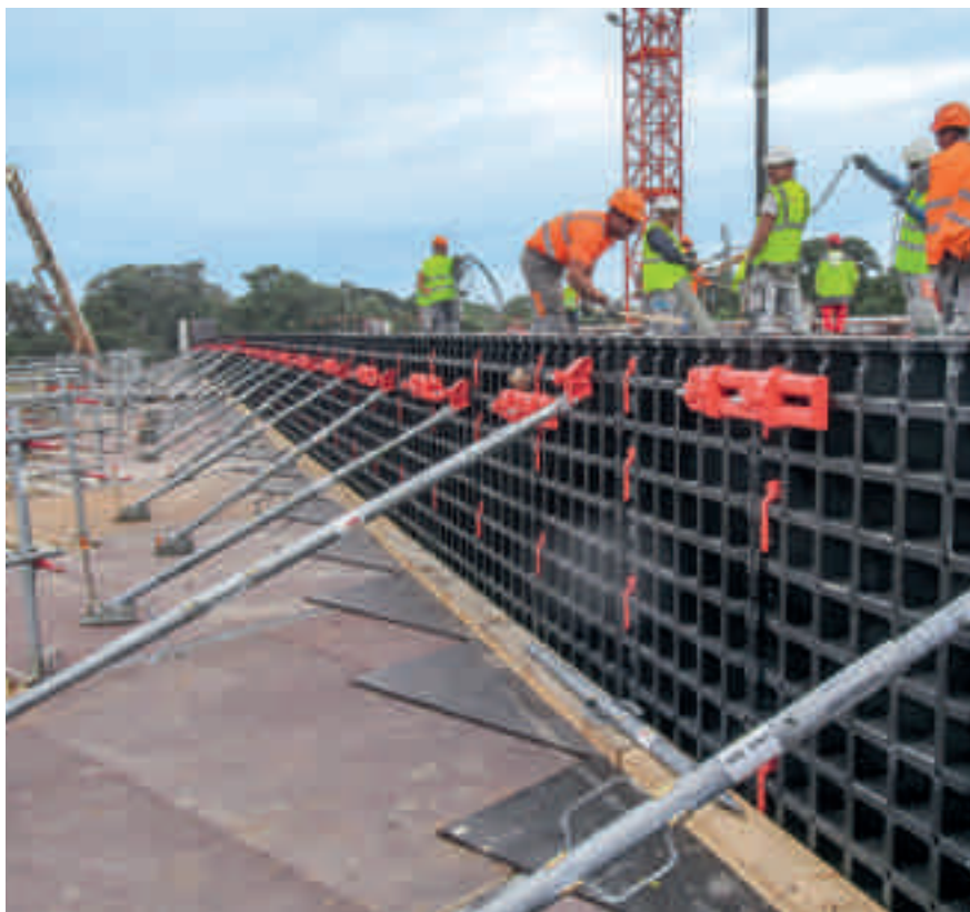
DUO vďaka svojim panelom s malými rozmermi a nenáročnou manipuláciou bol predurčený na debnenie základov.
