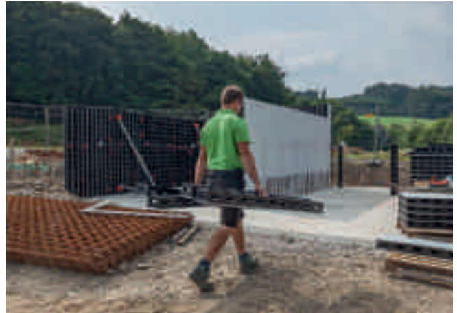
Novodobé použitie debnenia v sektore spojenom s krajinou úpravou, pri ktorom bolo nasadené DUO pre debnenie kontajnerov na sypký materiál.
