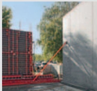
Pravidelné rozmiestnenie spojov a otvorov po tiahlach na pohľadovej ploche. Outlet Center, Metzingen, Nemecko
